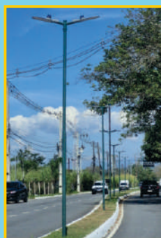
Iluminação de Avenida Rubem Mader - Jardim Martineli
